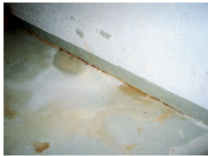
Abb. III.1.21: Wassereintritt durch die Fuge zwischen Kellerwand und Fundament in Höhe des Kellerbodens bei nichtdrückendem Wasser
