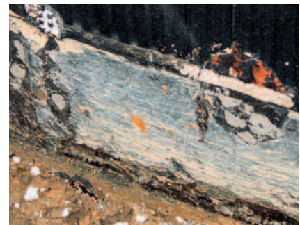
Abb. III.1.26: Ungeeignete Schutzschicht führt zum Durchstanzen der Abdichtungsschicht.
