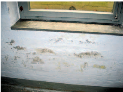
Abb. III.1.20: Fleckenförmige Durchfeuchtung der Innenseite einer Bauwerksaußenwand bei Bodenfeuchte
