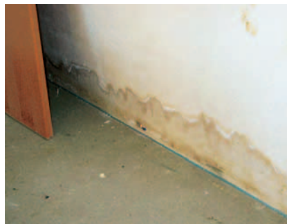
Abb. III.1.25: Wassereintritt wegen Abdichtungsfehlern und fehlerhaftem Drainageanschluss
